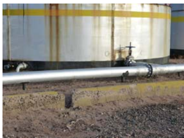
Muro de contención de derrames sin estanqueidad en Bateria
