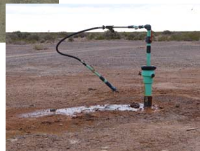
Inyector con pérdida en válvula de control, y sin cerco perimetral
