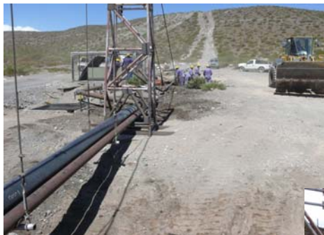
Incidente en cámara de rebalse en oleoducto que atraviesa un arroyo, donde se hacen recomendaciones a la Empresa para la modificación de instalaciones a los efectos de minimizar el riesgo de derrame en esa área crítica.-
