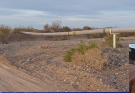
Tubería cruzando un cañadón en forma precaria
