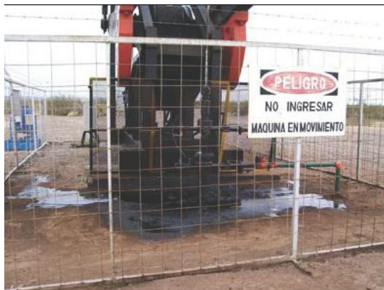
Se observa incidente en boca de pozo, afectando suelo en locación (instalación).
