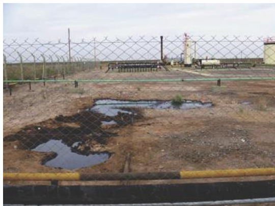
Se observa incidente en línea de conducción de ingreso a batería, afectando suelo en predio (instalación).
