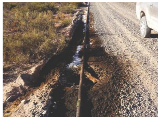
Se observa incidente en línea de conducción, afectando suelo en camino (instalación).
