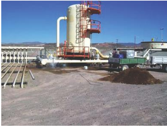
Se observa incidente en separador de batería, afectando suelo en predio de batería (instalación).
