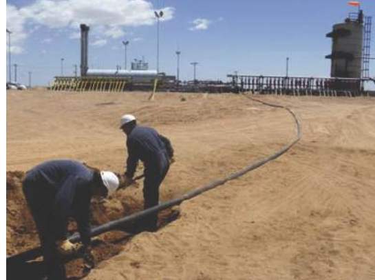
Se observa incidente en línea de conducción, afectando suelo en picada (instalación).
