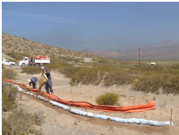
FOTO 6: se observa tendido de barreras y material absorbentes sobre posible línea de escurrimiento
