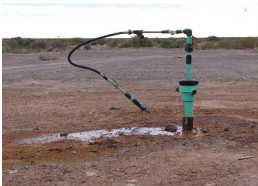
Inyector con pérdida en válvula de control, y sin cerco perimetral
