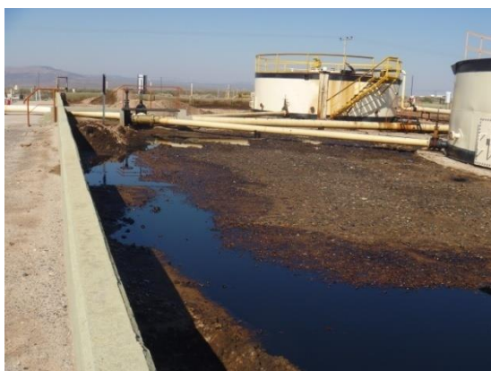
Se observa incidente en predio de batería, afectando suelo en instalación, quedando contenido por la presencia de muros de contención de derrames.
