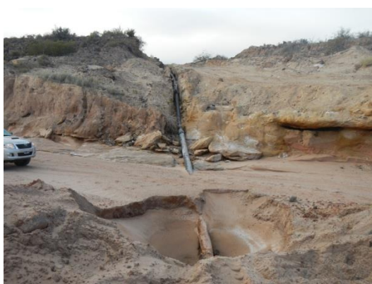
Línea de conducción sin defensa aluvional dentro de cauce.
