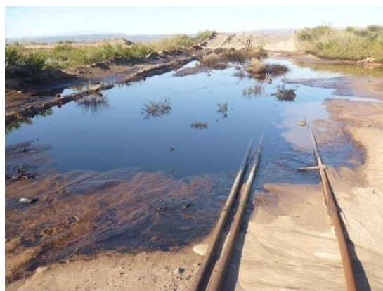
Se observa incidente en línea de conducción, afectando suelo en picada de línea (instalación).
