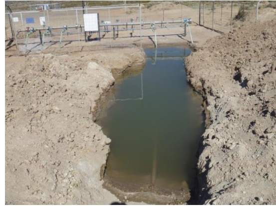
Se observa incidente en satélite de inyección de agua salada, afectando suelo en picada (instalación).
