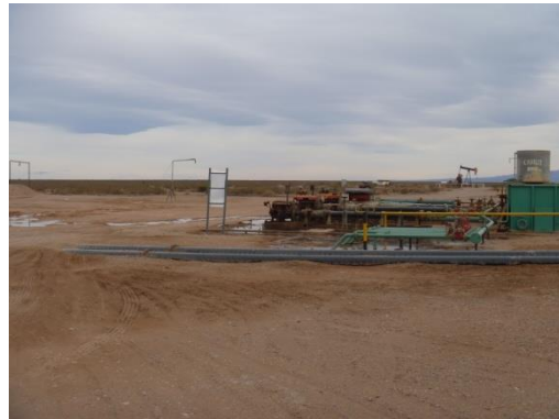
Se observa sector de bombas en Batería sin estructura de contención de derrames y con pérdidas de fluidos
