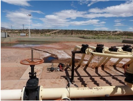
Se observa incidente en colector de batería, afectando suelo en predio de batería (instalación).
