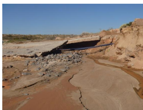
Líneas de conducción con defensa aluvional mal diseñadas dentro de cauce
