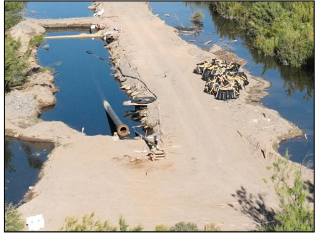
Foto 4. Ducto de acero en punto de partida, dentro de zanjeo inundado. Presencia de agua a ambos laterales de la picada.
