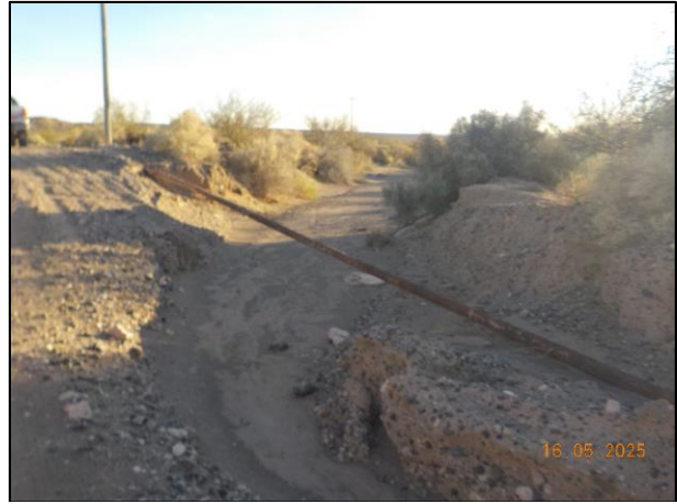
Foto 14. Coord. -38.232873 -67.921472. Se observa línea de conducción descubierta y sin defensa sobre cauce aluvional. En caso de estar en servicio, defender adecuadamente. Caso contrario, retirar las líneas o en su defecto y sólo de manera provisoria verificar purgado / inertización de la misma y desconexión a cualquier tipo de fuente.
