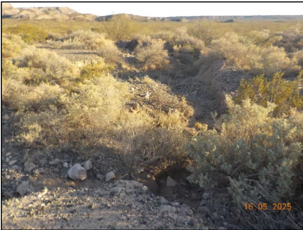
Foto 15. LB-1020. Reacondicionar Zanja/berma perimetral de contención de locación, erosionada en vértice Noreste, formación de cárcava.
