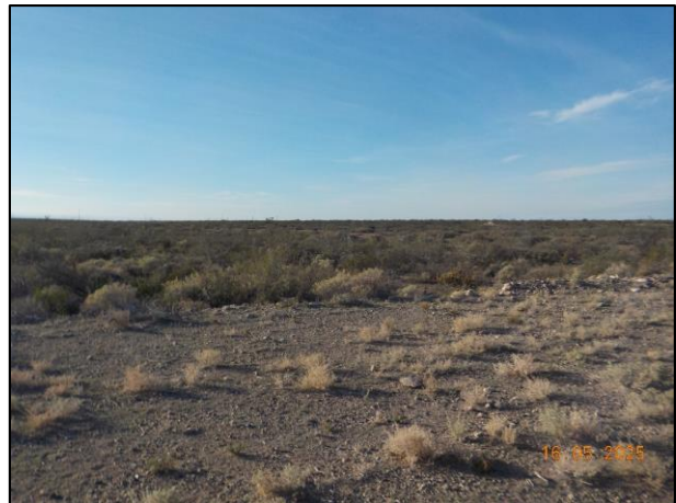
Foto 18. LB-1028. Reacondicionar zanja/berma perimetral de contención de locación en lateral Este, se observa discontinuidad.
