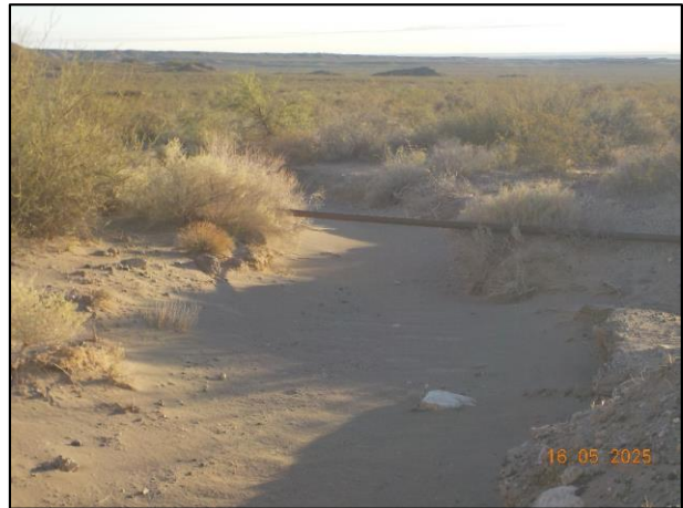
Foto 10. Coord. -38.234234 -67.926248. Se observa línea de conducción descubierta y sin defensa sobre cauce aluvional. En caso de estar en servicio, defender adecuadamente. Caso contrario, retirar las líneas o en su defecto y sólo de manera provisoria verificar purgado / inertización de la misma y desconexión a cualquier tipo de fuente.
