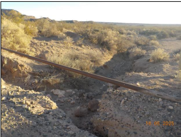
Foto 11. Coord. -38.234723 -67.925381. Se observa línea de conducción descubierta y sin defensa sobre cauce aluvional. En caso de estar en servicio, defender adecuadamente. Caso contrario, retirar las líneas o en su defecto y sólo de manera provisoria verificar purgado / inertización de la misma y desconexión a cualquier tipo de fuente.
