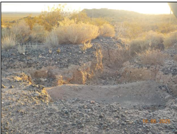
Foto 3. LB-1016. Reacondicionar Zanja/berma perimetral de contención de locación, erosionada en vértice Noreste, formación de cárcava.
