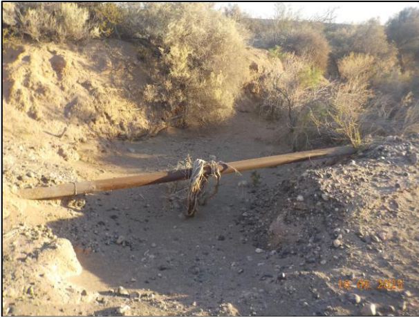
Foto 13. Coord. -38.232741 -67.921908. Se observa línea de conducción descubierta y sin defensa sobre cauce aluvional. En caso de estar en servicio, defender adecuadamente. Caso contrario, retirar las líneas o en su defecto y sólo de manera provisoria verificar purgado / inertización de la misma y desconexión a cualquier tipo de fuente.
