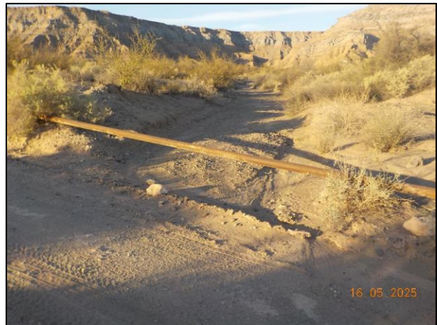
Foto 12. Coord. -38.235186 -67.924501. Se observa línea de conducción descubierta y sin defensa sobre cauce aluvional. En caso de estar en servicio, defender adecuadamente. Caso contrario, retirar las líneas o en su defecto y sólo de manera provisoria verificar purgado / inertización de la misma y desconexión a cualquier tipo de fuente.
