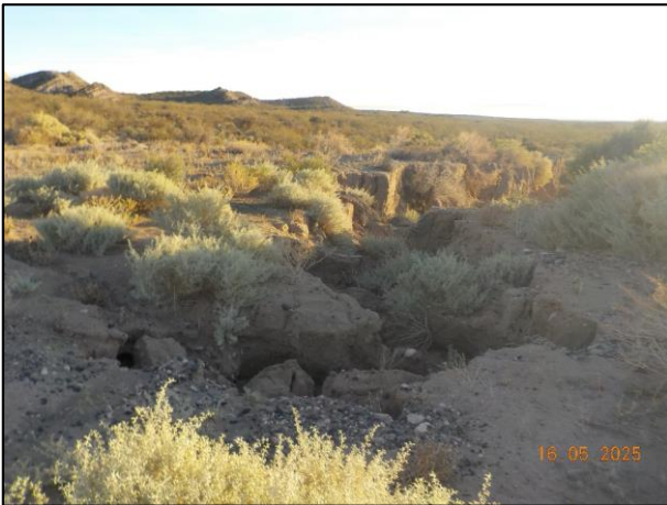
Foto 9. LB-1013. Reacondicionar Zanja/berma perimetral de contención de locación, erosionada en vértice Norte, formación de cárcava.
