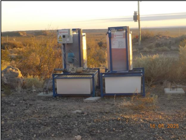
Foto 1. LB-1016. Colocar cerco a recipiente de producto químico o incorporarlo a cerco de equipo.
