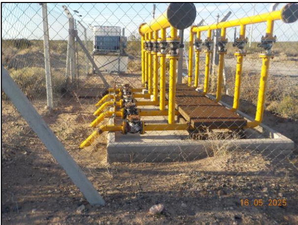
Foto 17. Colector ingreso LB-1024. Se sugiere ampliar estructura de contención, de forma tal que permita incluir las acometidas de líneas.
